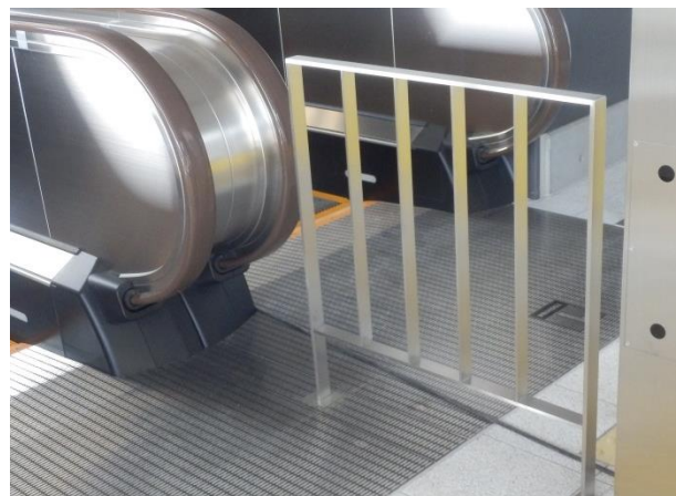
東口昇降設備付近 安全柵
